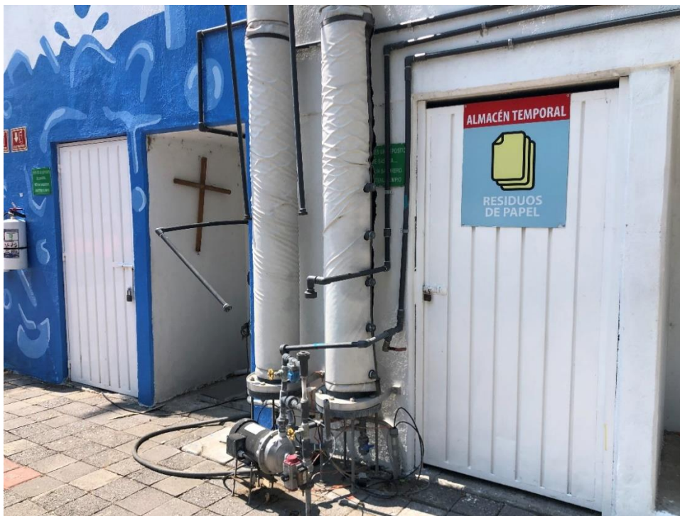
Ilustración 10 Almacén temporal de papel y cartón en planta de tratamiento de agua dentro del campus IBERO Puebla
