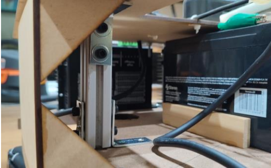
Fig. 8. Soportes estructura interna.
