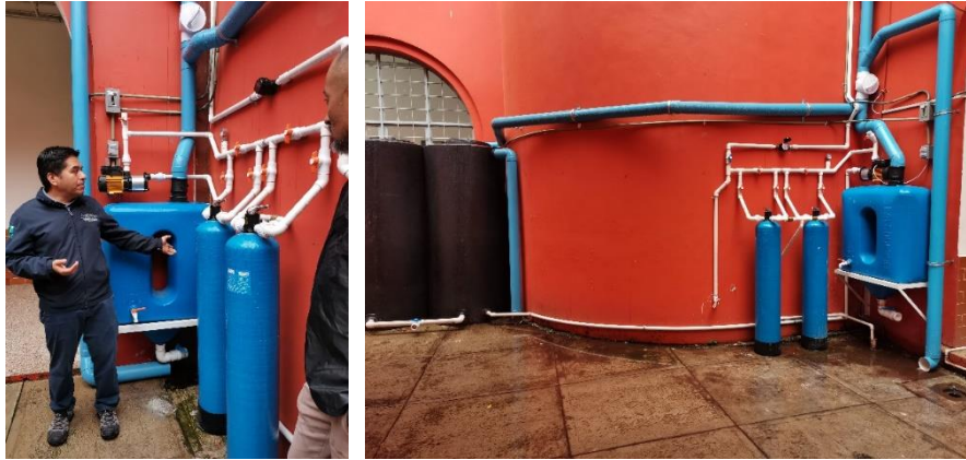
Ilustración 53. Sistema de captación, filtración y desinfección de agua pluvial. Fotos: Pamela Núñez.
