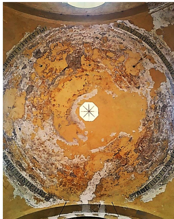
FIGURA 85. Daños que la humedad ha causado a la cubierta de la sacristía.
