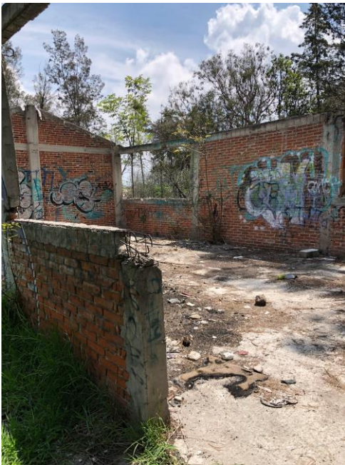
Imagen 9: Construcción abandonada dentro del predio.
