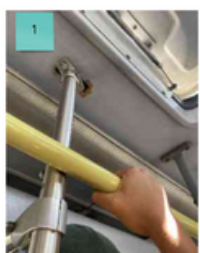
El barandal estaba roto, senti que se iba a romper porque se movia mucho
