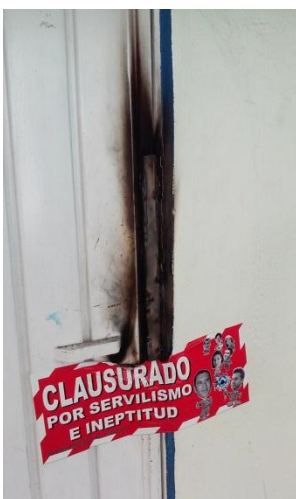
Ilustración 19. Puertas de la presidencia municipal de San Andrés soldadas. Los habitantes de Tlaxcalancingo llegaron con herramientas para soldar las puertas de la presidencia clausurando las entradas. Los funcionarios ya habían evacuado el edificio previamente. Gabriela Di Lauro.
