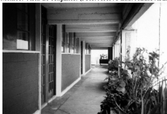
Fig. 2. Centro Urbano Presidente Alemán, ciudad de México. Vista actual de uno de los corredores que dan acceso a los apartamentos. (Foto: Acervo Lab. Audiovisual, Inst. Mora)
