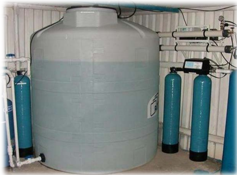
Imagen 15.1. Planta purificadora el Fortín
