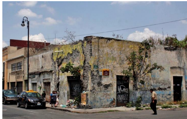
FIGURA 4. Vivienda abandonada y deterioro urbano general en el Barrio del Refugio. El Sol de Puebla.
