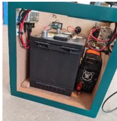
Fig. 11. Interior de la estación de carga
