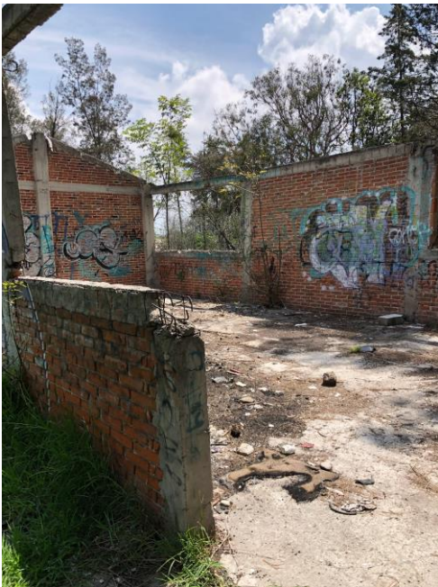
Imagen 9: Construcción abandonada dentro del predio.
