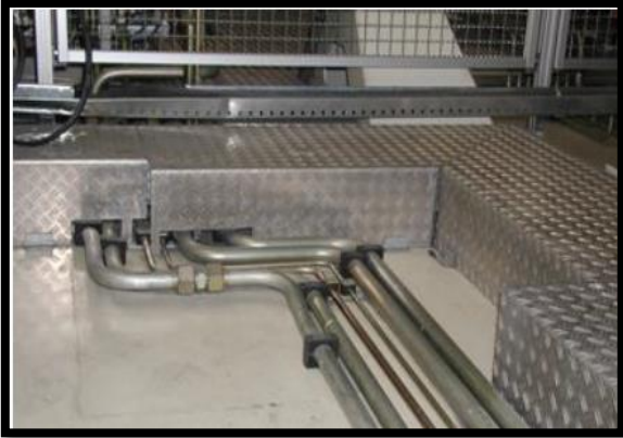
Ilustración 41, condición inicial de tuberías. Fuente, elaboración propia del alumno.
