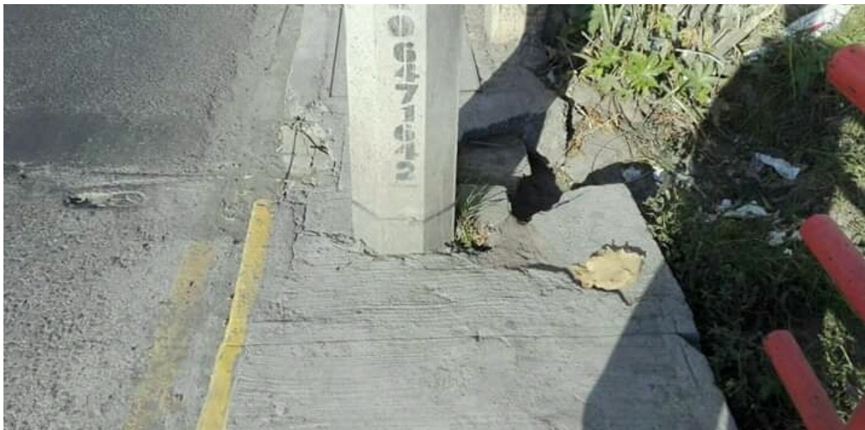
Imagen IX: Banqueta destruida e invadida en Calle 6 Norte. Fuente: Elaboración propia.
