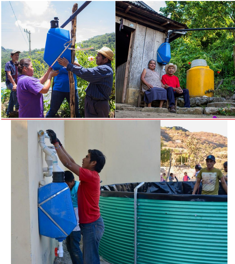
Imagen 29. Sistema de captación de agua “Isla Urbana”. Fuente” Isla urbana (2019).
