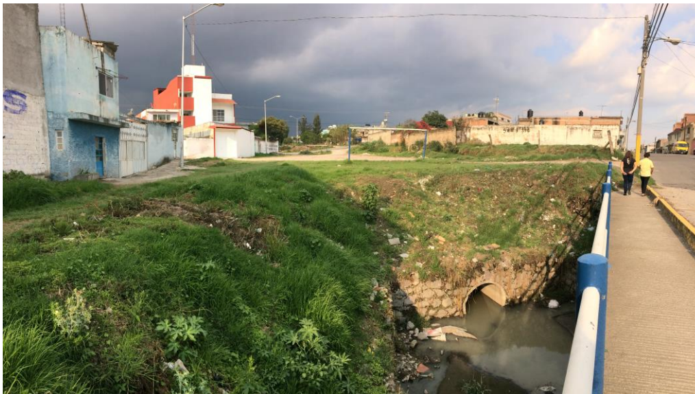
Ilustración 22. Último tramo entubado de la calle Xaltonac. Fotografía tomada por la autora el 3 de junio de 2017.
