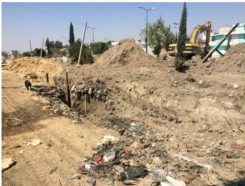
Ilustración 24. Excavaciones para obras de drenaje pluvial en la calle Brindissi, entre calle Salamanca y Londres. Fotografía tomada por la autora el 26 de marzo del año 2018.
