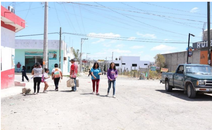
FOTO 5: Ausencia de pavimentación en la Colonia Valle del Paraíso. Foto propia.
