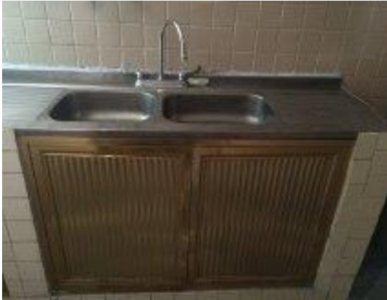
Figura 3.5 Lavador de manos de quirófano
