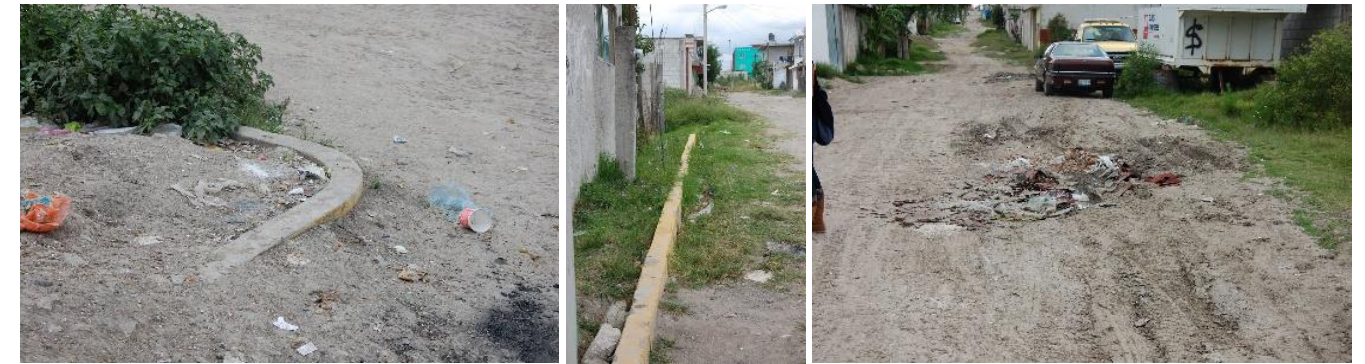
Ilustración 5. Estado Físico de la Vía Pública. (Autoría, 2015)
