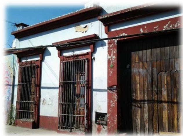
Fachada 2. Ejemplo de vivienda abandonada en el centro histórico
