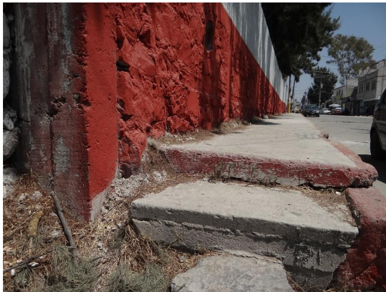
Imagen 17. Condiciones que presenta la banqueta en la Tlaloc donde transitan los usuarios Fuente: Elaboración propia en recorrido de campo realizado, 2018
