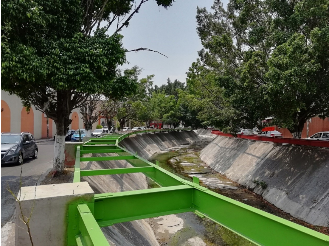
Ilustración 14. Ciclovía inconclusa en el paseo Alejandro Cervantes Delgado esquina con la calle Hermenegildo Galeana. Fotografía tomada por el autor el 22 de abril de 2018.
